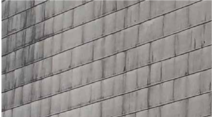
Missstand Beispiel: Materialität der Fassade
