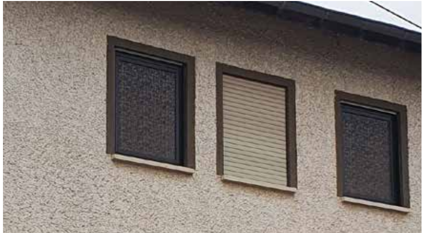
Modernisierungs- und instandsetzungsbedürftiges Gebäude mit mittlerem Bedarf
